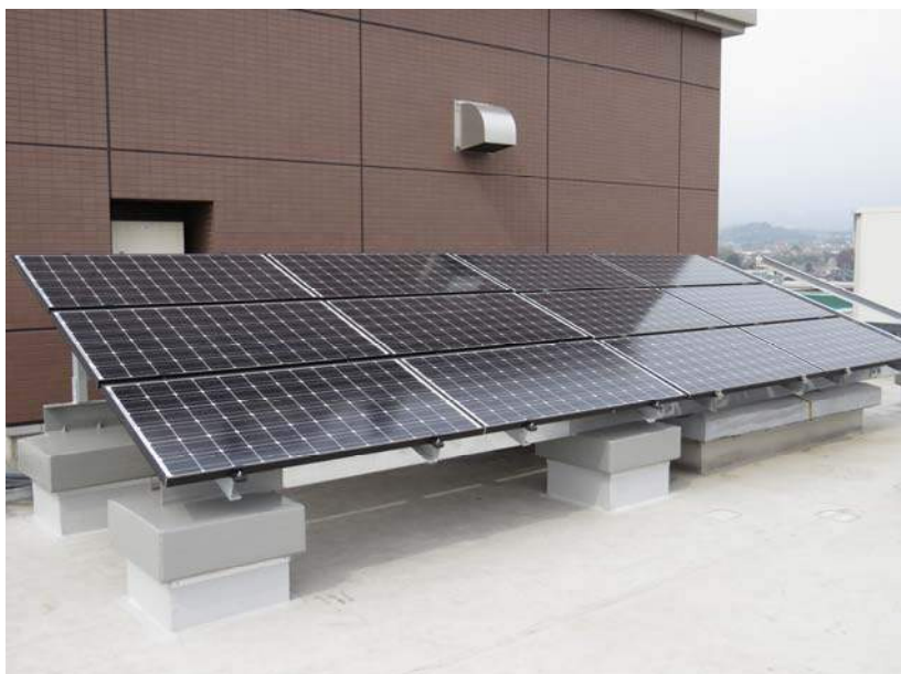
写真 群馬大学荒牧キャンパス・社会情報学部棟屋上に設置した太陽光パネル。 2013年3月に、2,280Wに増設した直後の様子
